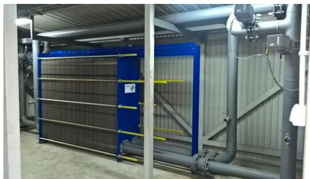
Rysunek 9. Oczyszczalnia ścieków w Cukrowni Dobrzelin po modernizacji: wymiennik płytowy ciepła z układem sterowania [opracowanie własne]
