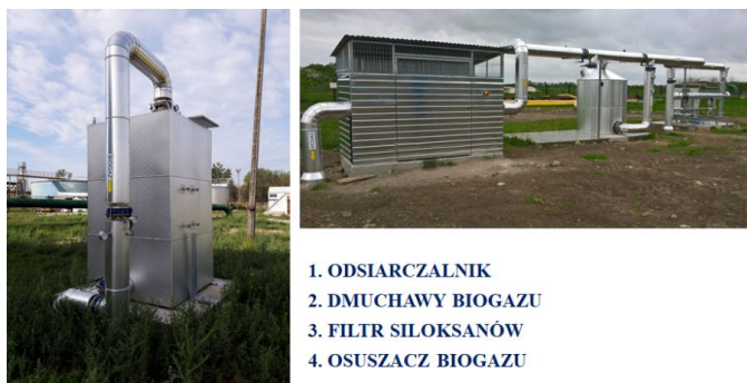
Rysunek 7. Oczyszczalnia ścieków w Cukrowni Dobrzelin po modernizacji: system oczyszczania biogazu [opracowanie własne]
