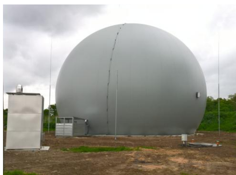
Rysunek 8. Oczyszczalnia ścieków w Cukrowni Dobrzelin po modernizacji: zbiornik biogazu [opracowanie własne]
